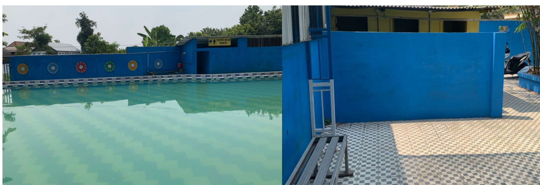
Gambar 1. Keadaan Dinding di Area Kolam Renang Alas Outbound Edukasi Dusun Ngingas, Desa Simpang.
